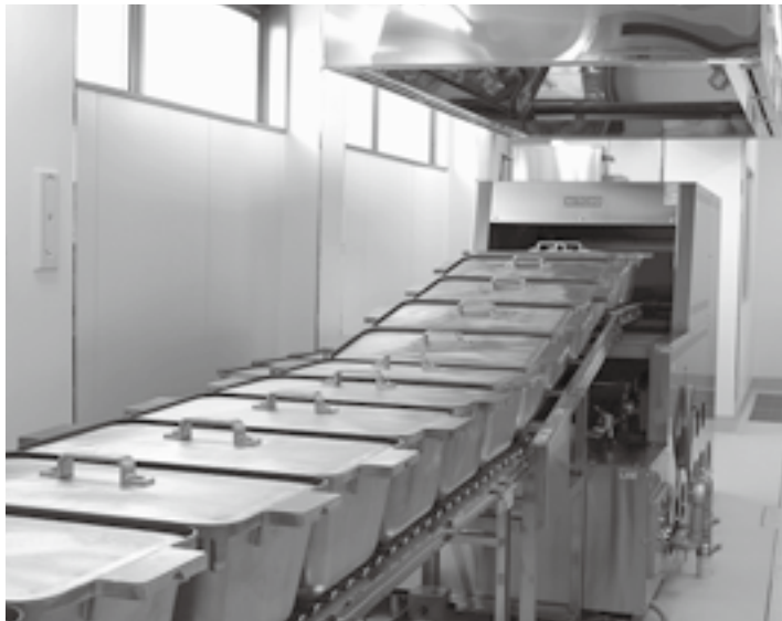
新給食センターに新たに設置されたコンベアー方式の炊飯設備 (新しい機器では炊き込みご飯を作ることでもある)
