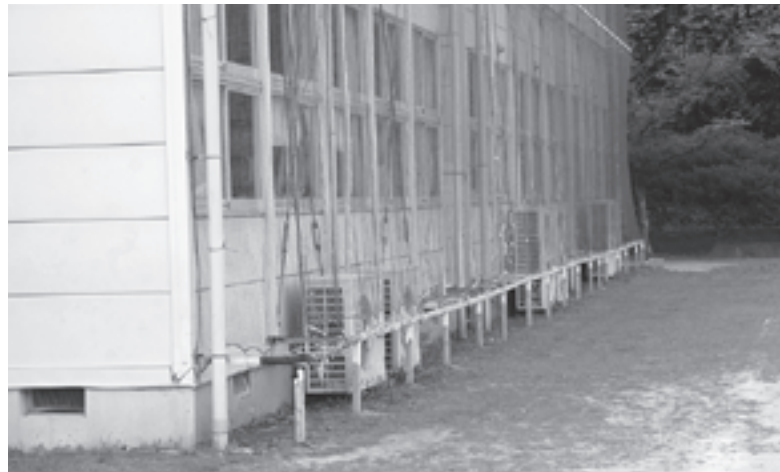
山鹿小学校のプレハブ教室のみに設置してあるクーラー
