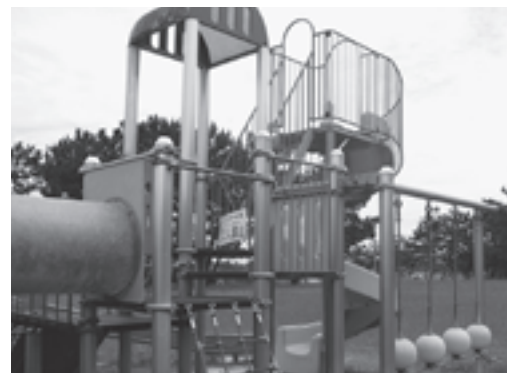
補修予定の海浜公園遊具 (H26.7.17)
