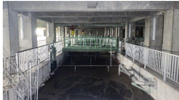
下水道処理施設内
