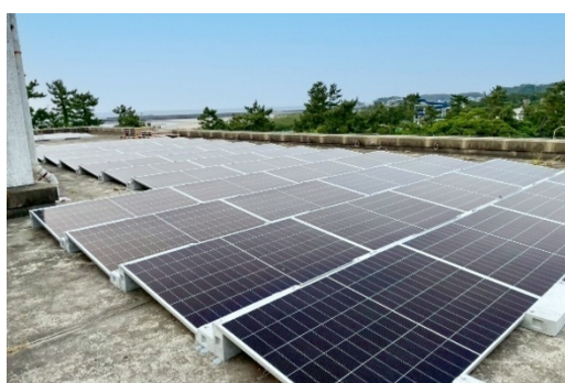
浄化センターの太陽光パネル
