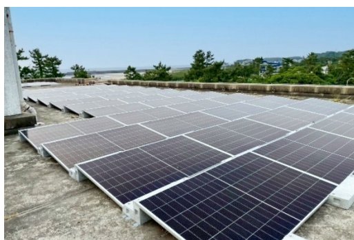
浄化センターの太陽光パネル
