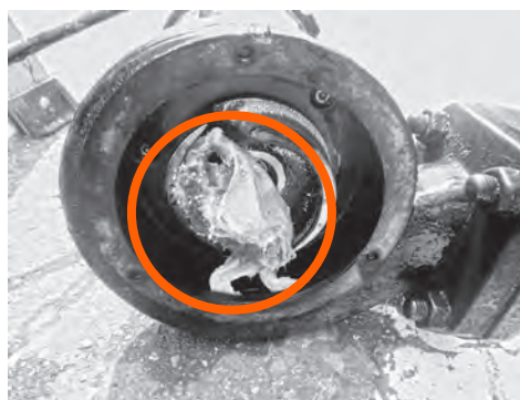
◀汚水ポンプに異物が詰まっている状況
