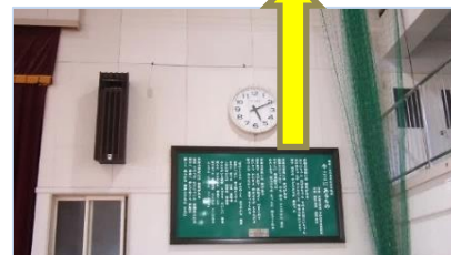
体育館ステージ右 壁時計下に設置
