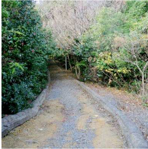
第1展望所から第2に向かう園路は、雨水によって舗装材が流出している
