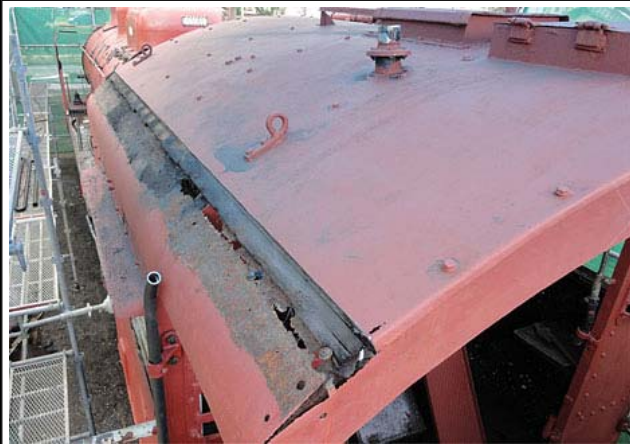
運転室屋根の腐食した雨樋の修理の様子です。(右の写真も参照)
